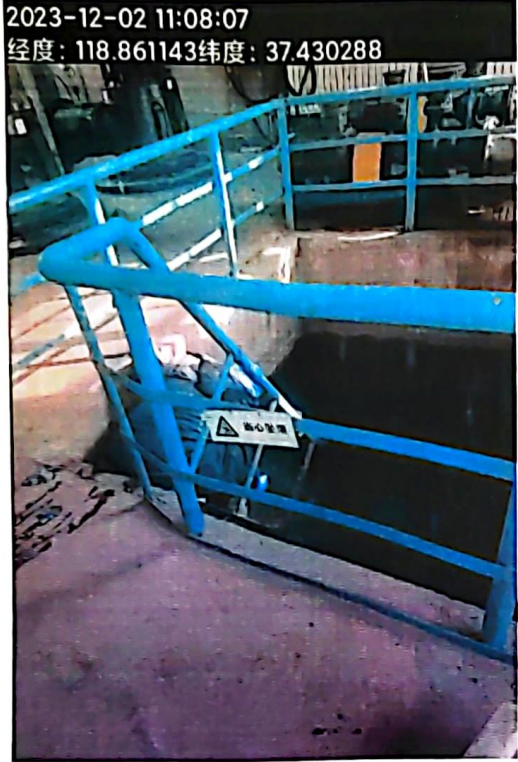
DW001车间废水总排口
